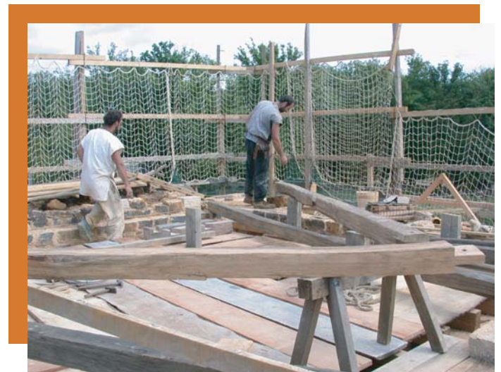
Les éléments de la charpente sont assemblés avant d'être levés à la verticale
