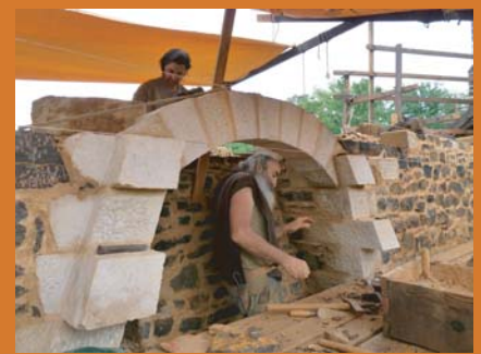
arc de décharge de la cheminée
