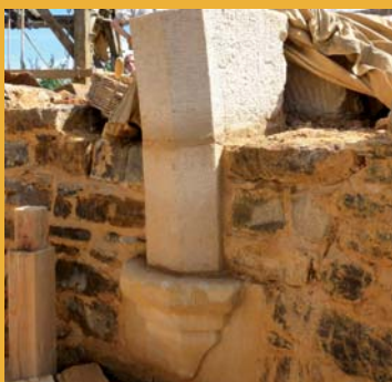
Les culots et les deux premiers sommiers ont été maçonnés sur chacune des 6 nervures de la voûte.
