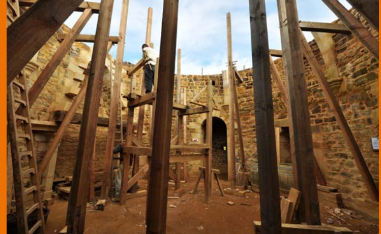
29 août 2010 : les charpentiers installent les écoperches en bois qui soutiendront le cintre.
